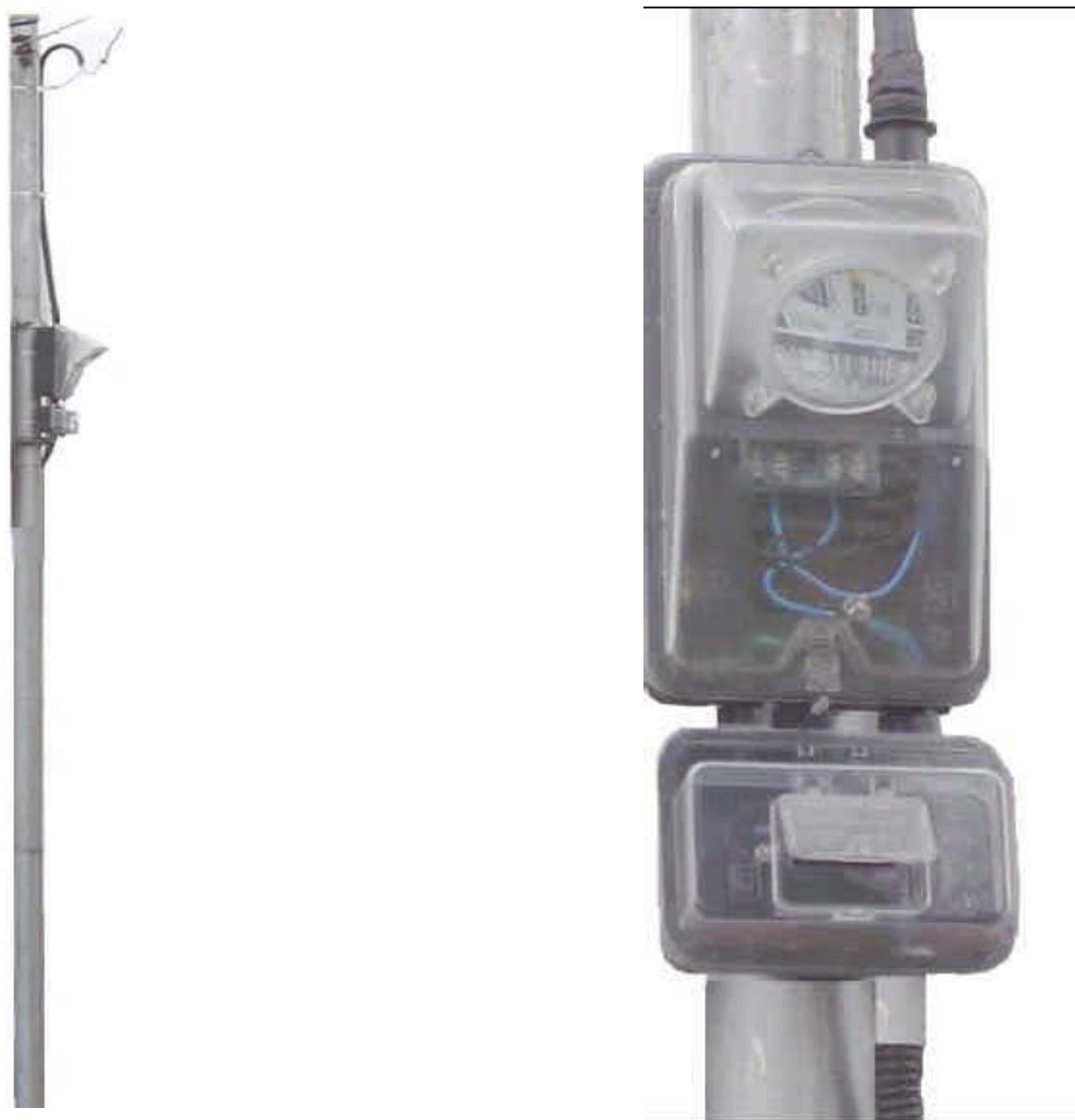
Figura 1 - Estrutura com Caixa de Medição em poste particular
