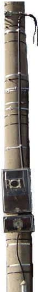
Figura 2 - Estrutura com Caixa de Medição em poste da AES Eletropaulo
